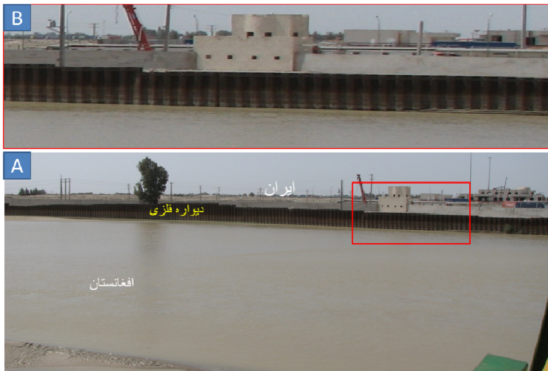
شکل ۸. موانع ساخته شده برای تعدیل فرسایش ساحل غربی هیرمند در محل پل ابریشم و گمرک میلک؛ (A) نمایی از دیواره فلزی ساخته شده؛ (B) نمای نزدیک از مستطیل قرمز در تصویر A معرف دیوار ساحلی و تأسیسات گمرک در ساحل غربی
