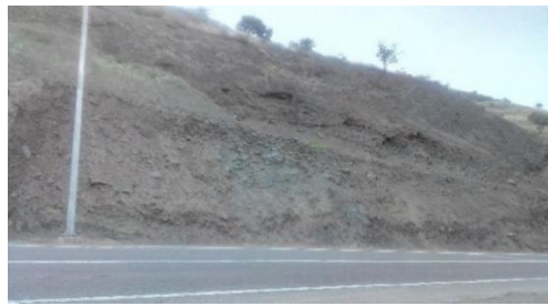
شکل ۱۱: رخنمون رسوبات منفصل و مستعد لغزش در اطراف جاده خلخال - سرچم در امتداد دره کیوی چای در نتیجه ایجاد ترانشه
