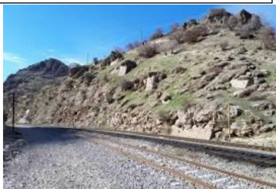
ترانشه ناپایدار کیلومتر ۴۷۹+۱۰۰
