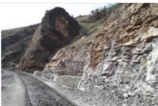
ترانشه ناپایدار کیلومتر ۵۱۸+۷۰۰
