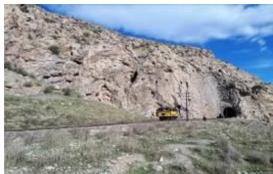
ترانشه ناپایدار کیلومتر ۴۷۶+۵۰۰
