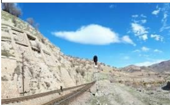
ترانشه ناپایدار کیلومتر ۴۷۷+۸۵۰
