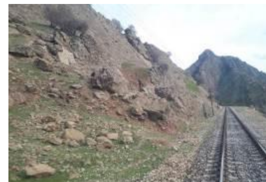
ترانشه ناپایدار کیلومتر ۴۲۶+۵۰۰
