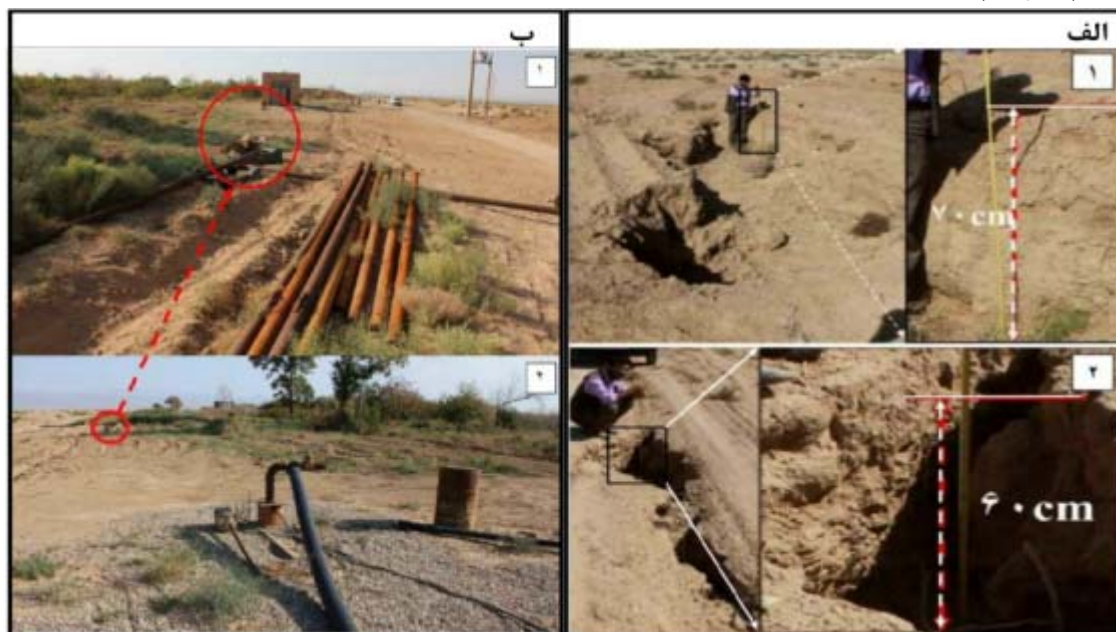
شکل ۱۱- تأثیر پذیری زیرساخت‌های کشاورزی و زراعی از فرونشست زمین: الف) ۱- فرونشست در ارتباط با زمین‌های زراعی نقطه ۲- فرونشست در ارتباط با زمین‌های زراعی و راه - ب) تغییر مکان چاه به علت تخریب جدار و آسیب دیدگی تأسیسات چاه و کاهش میزان آبدهی: ۱- مکان اولیه چاه به همراه تأسیسات تخریب شده. ۲- مکان جدید چاه
