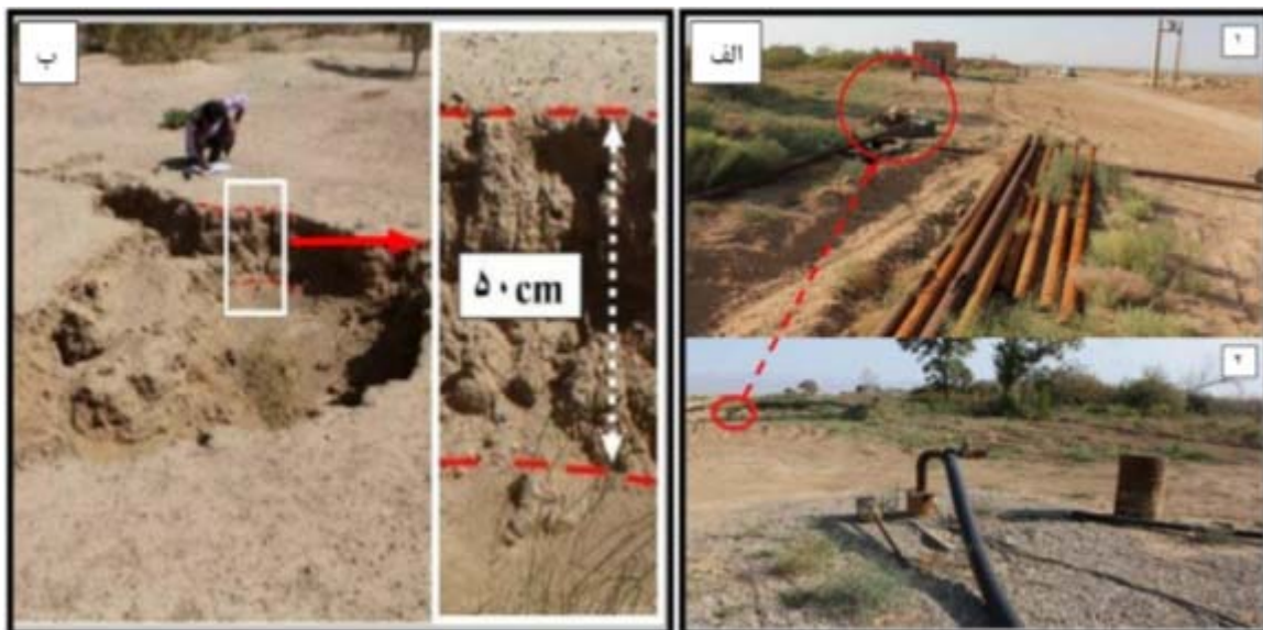
شکل ۱۲: الف: تغییر مکان چاه به علت تخریب جدار و آسیب‌دیدگی تأسیسات چاه و کاهش میزان آبدهی: (۱) مکان اولیه چاه به همراه تأسیسات تخریب شده. (۲) مکان جدید چاه ب: فرونشست در ارتباط با پشته قنات
