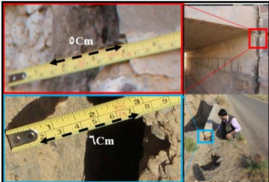
شکل ۸: گسیختگی بین دیواره و سقف پل از ابنه راه (آسفالته) دامغان به منطقه مزرعه یحیی) متأثر از وقوع در عرصه در حال فرونشینی به شرح شکل ۱۱
