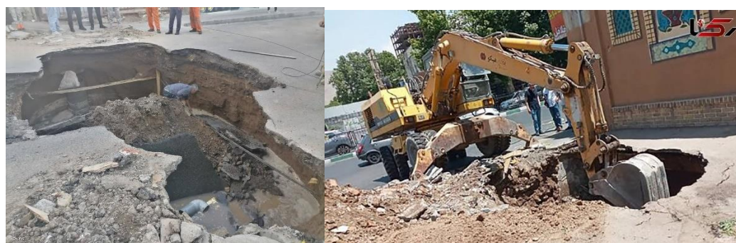
شکل ۱۰. سمت راست فرونشست زمین در تاریخ ۱۴۰۱/۰۳/۱۴ در ساعت ۱۱ صب در منطقه شهری میدان کرج-جنب سینما هجرت سمت چپ فرونشست زمین در تاریخ ۱۴۰۲/۰۲/۰۶ در ساعت ۱۴ بعد از ظهر در منطقه خیابان شهید بهشتی-خیابان ادهم
