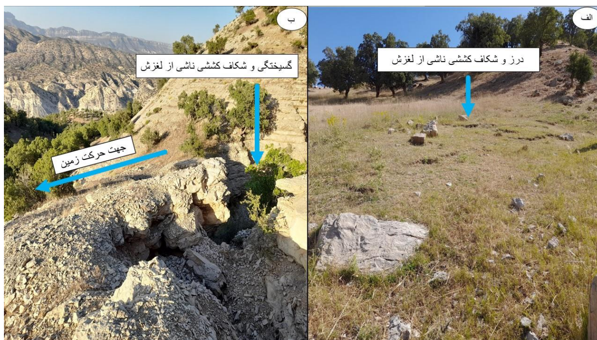
شکل ۷: درز و شکاف‌ها و گسیختگی‌های سطحی در زمین لغزش‌های واقع در جنوب ایلام. الف: زمین لغزش شماره ۴. ب: زمین لغزش شماره ۳
